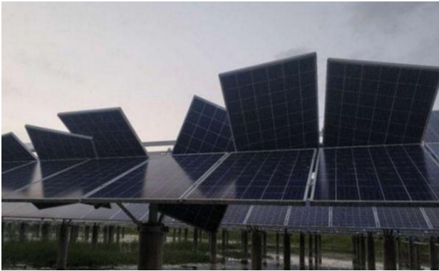
图1 台风“温比亚”使某光伏电站受损情况
