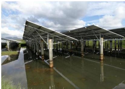
(a) 少数支架立柱发生了南向的倾斜弯曲变形
