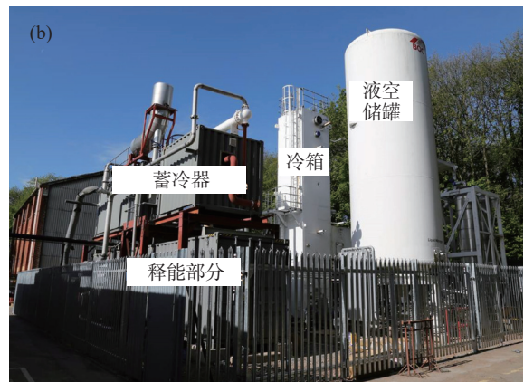
图 1 LAES 中试装置的流程图 (a) [19] 和现场照片 (b) [11] Fig. 1 Flow chart (a) [19] and site photo (b) [11] of LAES pilot plant
