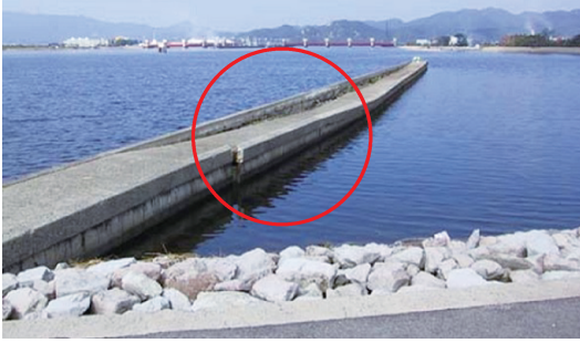
图1 防波堤在波浪荷载下的破坏图
