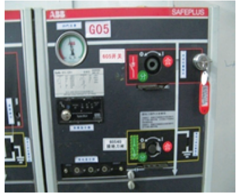
图 8 环网柜对侧开关上安装的闭锁锁具
