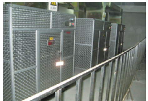
图 10 变压器箱门上安装的闭锁锁具
