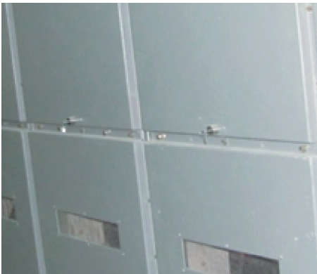
图4 中压盘柜后柜门上安装的闭锁锁具
