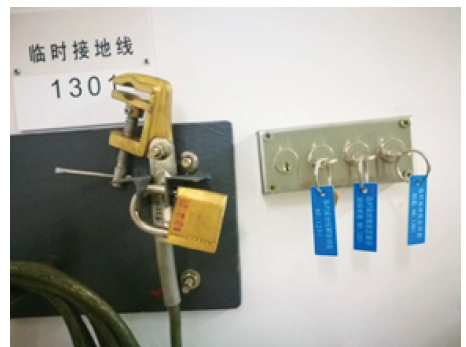
图6 临时接地线纳入闭锁逻辑
