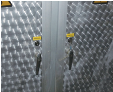
图3 厂用变压器箱门上安装的闭锁锁具
