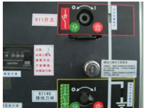
图 9 环网柜电缆进线地刀上安装的闭锁锁具
