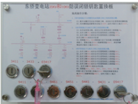
图 13 安装在配网 35 kV/10 kV 小型变电站的钥匙置换板
