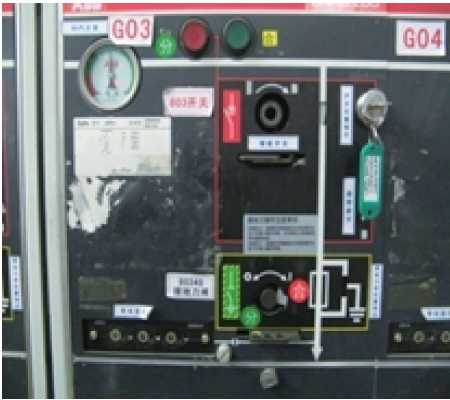
图 11 变压器网门对应负荷开关上安装的闭锁锁具
