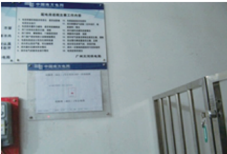
图 12 变压器网门上安装的机械五防锁具
