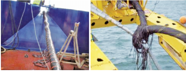
图1 海底电缆损伤图例
