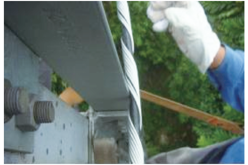
图 2 悬垂金具处光缆与铁塔发生摩擦
