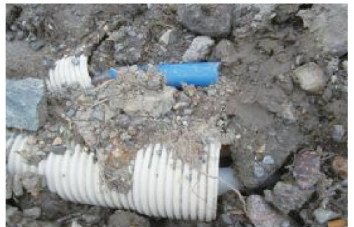
图 3 光缆错位变形导致断裂
