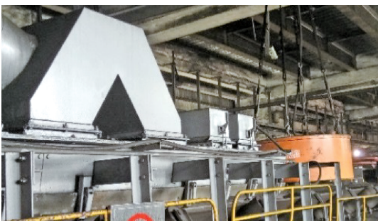
图 8 钦州电厂运行中的 IFT 落煤管及无动力导料槽
