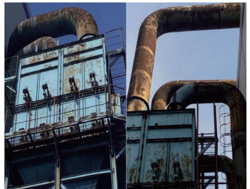
图1 某电厂已经停运的除尘器设备
