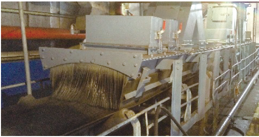
图 7 舟山电厂正在运行的无动力除尘导料槽
