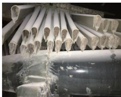
图6 管式除雾器管子内部存在固化浆液
