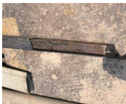
图7 管式除雾器支撑梁保护壳破损内部锈蚀
