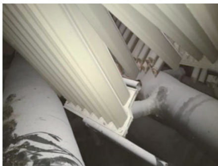
图4 管式除雾器管排与下端板焊缝拉坏
